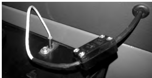
Rysunek 4 Czujnik temperatury spalin zamontowany w czopuch
